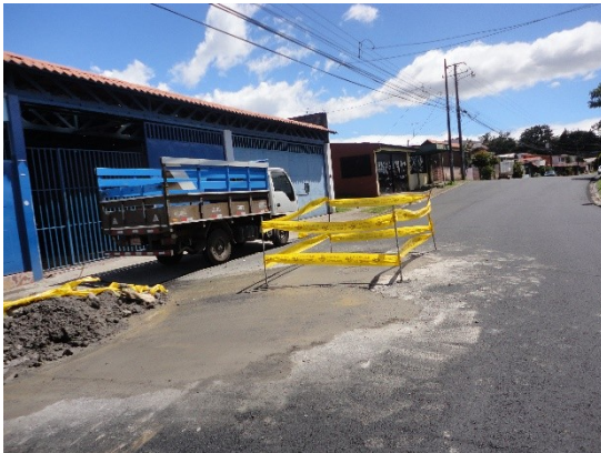
Imagen 1 Reparación de tubería por parte del A y A área de alcantarillado sanitario
